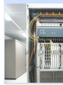
ELETTROMAGNETISMO (quadri elettrici)
